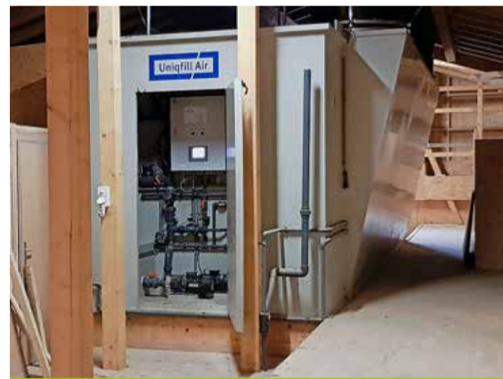
L'installation de purification de l'air à l'étage est adaptée au débit de l'air en été et offre des performances suffisantes. M. FISCHLER
