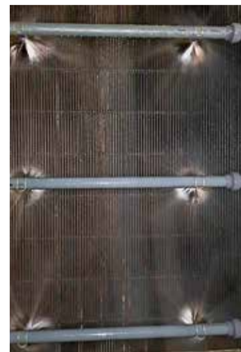
La poussière est séparée de l'air par un système de pulvérisation d'eau. M. FISCHLER
