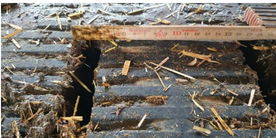
Abbildung 9: MeadowFloor-Boden mit den Rillen für den Abfluss des Harns und einer flachen Oberfläche (Quelle: Markus Bucheli, Berufsbildungszentrum Natur und Ernährung, Hohenrain, 14.09.2022).
