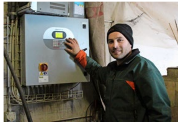
Über eine Steuerung kann Daniel Waser den Entmistungsschieber bedienen.
